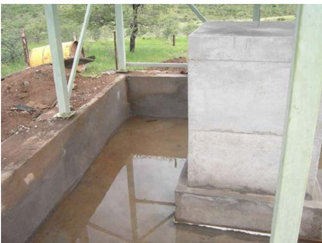
Abb.19: Ein erster Regenguss verwandelt den frisch betonierten Untergrund in ein Schwimmbad
