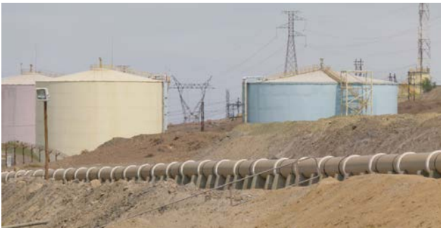
Abb. 11: Wasserpipeline und Wassertanks zur Versorgung der Uranaufbereitungsanlage der Rössing-Mine in der Namib-Wüste. – Foto: Rainer Glawion
