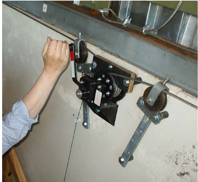
Abb. 7: Der Rolldachantrieb mit Totmannbremse (unteres Seil)
