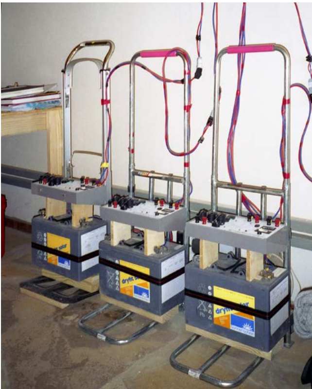
Abb. 6: Wanderbatterien an der Ladestation
