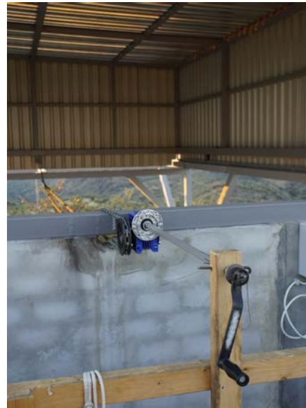
Kurbel und Getriebe zur Dachöffnung
